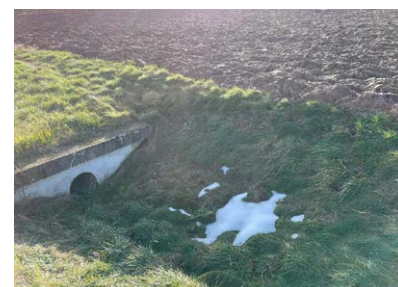
Koryto strouhy se postupně zanáší a zarůstá trávou
